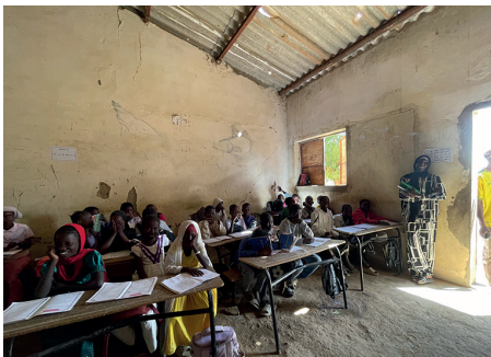
Franko-Arabe-Schule - kaputtes Dach
