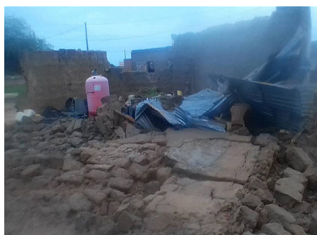
Eingestürztes Gebäude aus Lehm
